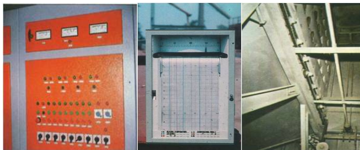
Slika 3: Izgled komandnog ormana, pisača i zone hlađenja kod sušare Pobeda
